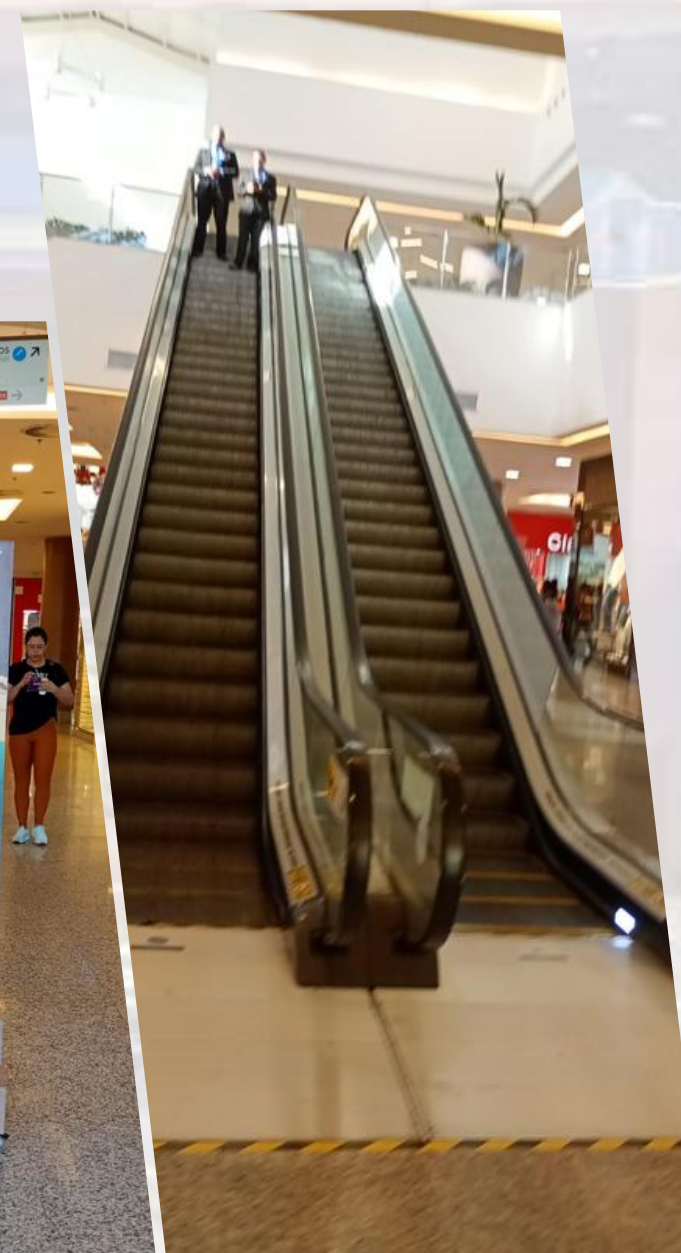
Escada Rolante (degraus)
